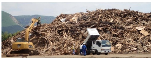
図1-5-2 平成28年熊本地震 阿蘇市の仮置場の木くず (平成28年6月)
